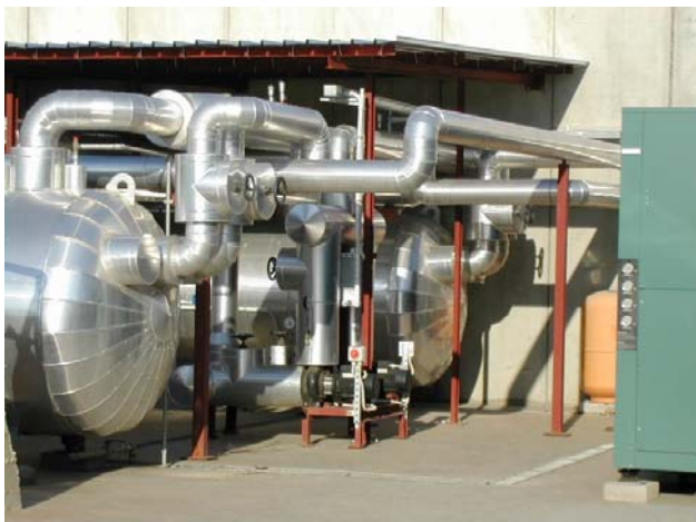
ACCUMULO TERMICO E PORTATA VARIABILE
